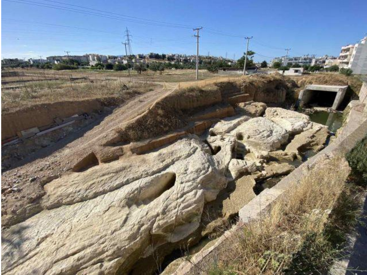
Υδραυλικό σύστημα στο έργο της διευθέτησης του ρέματος Εσχατιάς
